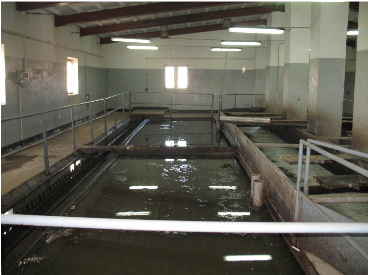
Wnętrze oczyszczalni ścieków
